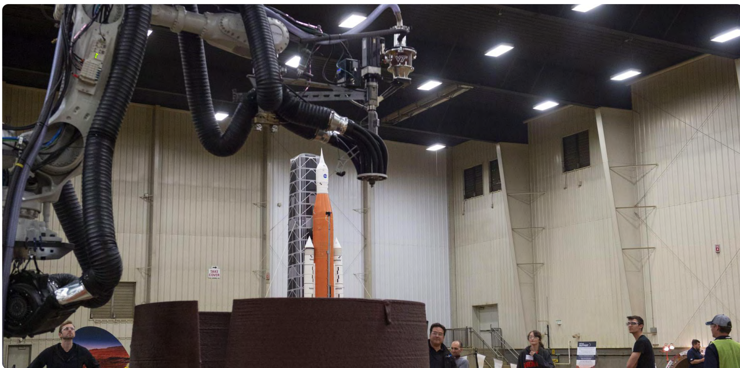
La impresora del equipo de AI SpaceFactory inserta de forma autónoma una ventana en su estructura de hábitat a subescala impresa en 3D en el Desafío de Hábitats Impresos en 3D de la NASA, celebrado en el Centro de Aprendizaje y Demostración Caterpillar Edwards en Edwards, Illinois, del 1 al 4 de mayo de 2019. Créditos: NASA
